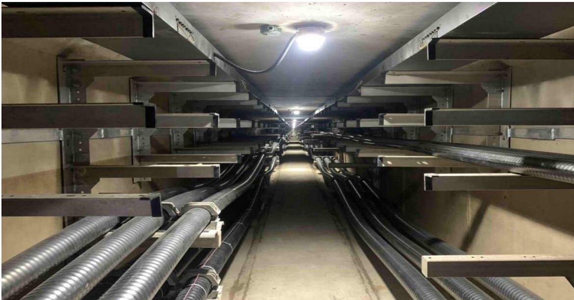
Obr. 3 - Podzemný prechodový káblový kanál Zdroj: Internet
