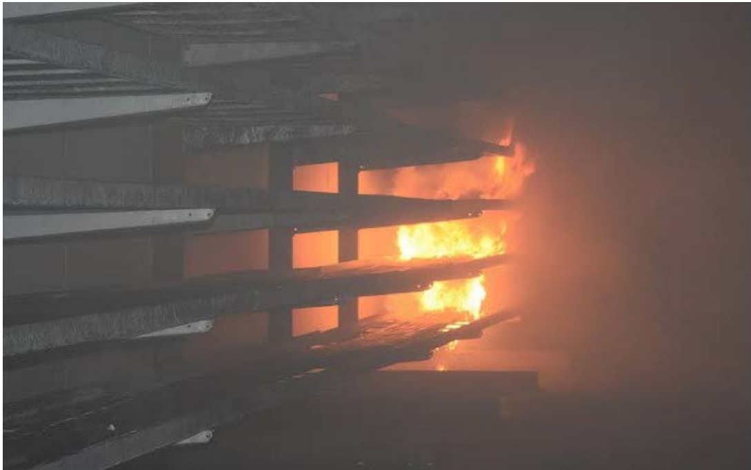
Obr. 1 - Požiar v priechodnom káblovom kanáli Zdroj: USSteel Košice
