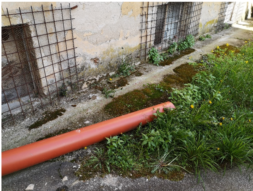
Obrázok 7 – Ukončenie dažďových zvodov v tesnej blízkosti objektu – výrazné napomáhanie zavlhania stavby Zdroj: autor
