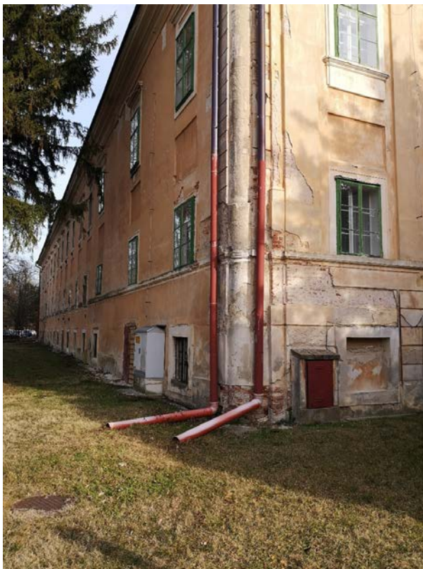
Obrázok 5 – Poškodené nárožia kaštieľa ako dôsledok pôvodných poškodených dažďových zvodov Zdroj: autor
