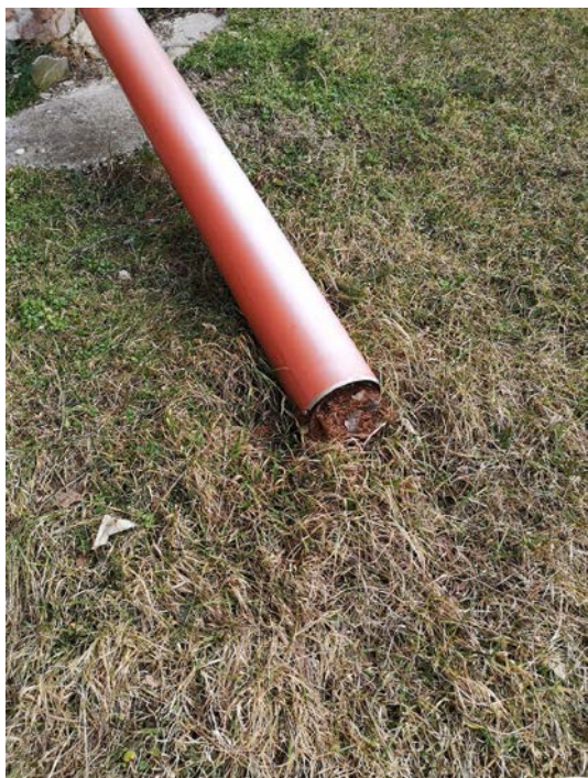
Obrázok 6 – Zdokumentovaná zanedbaná údržba dažďových zvodov – výrazné napomáhanie zavlhnutia stavby Zdroj: autor
